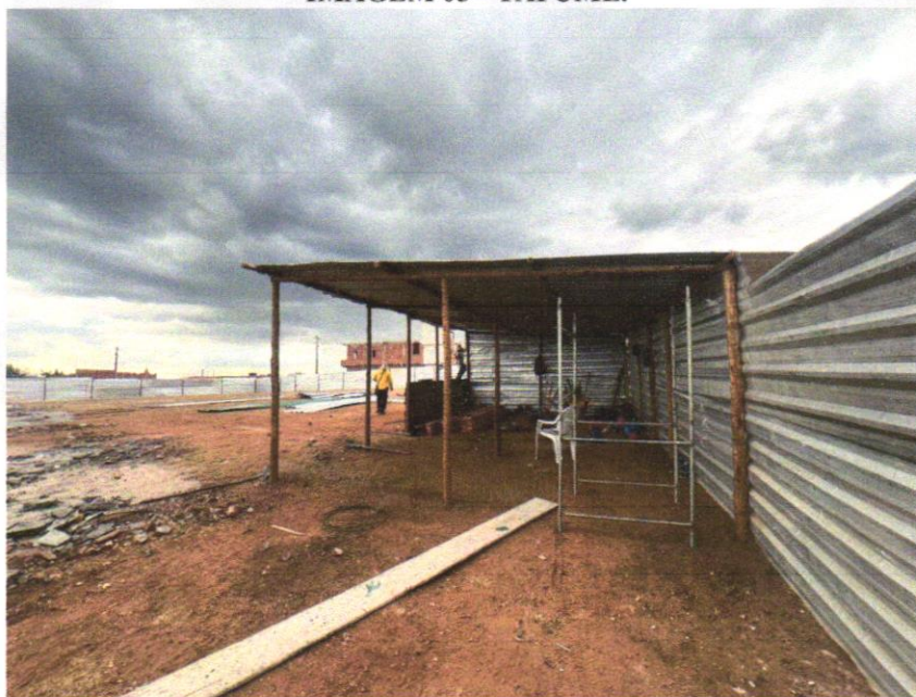
IMAGEM 04 - BARRACAO PARA DEPOSITO EM TABUAS DE MADEIRA, COBERTURA EM FIBROCIMENTO 4 MM, INCLUSO PISO ARGAMASSA TRAÇO 1:6 (CIMENTO E AREIA).
