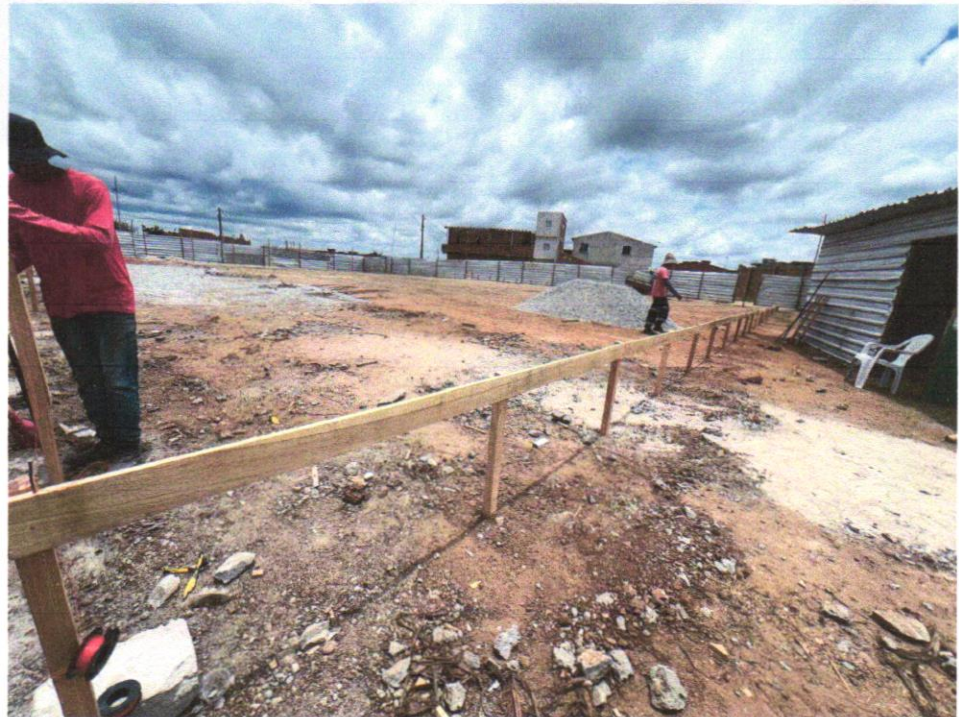
IMAGEM 06 - LOCAÇÃO CONVENCIONAL DE OBRA, ATRAVÉS DE GABARITO DE TABUAS CORRIDAS PONTALETADAS, SEM REAPROVEITAMENTO.
